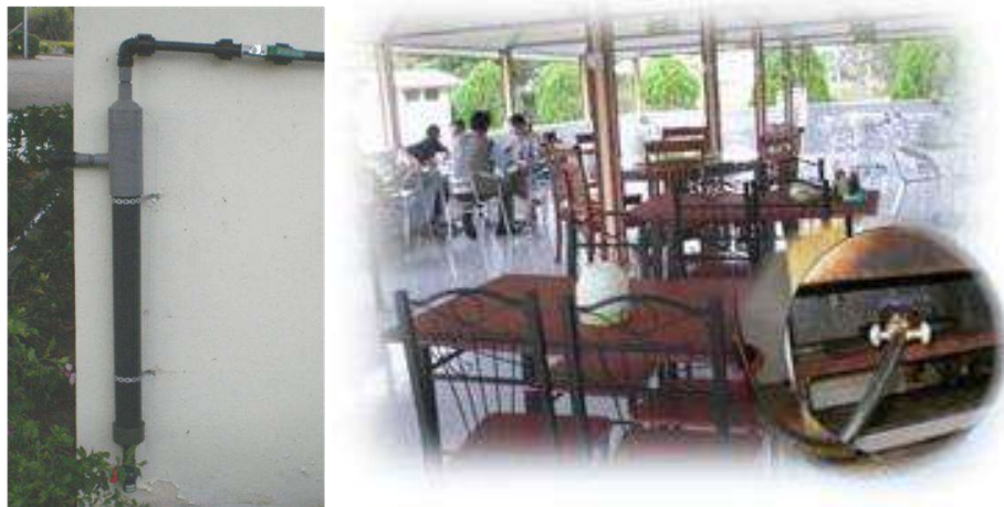
Gambar 23: Bekalan Biogas disalurkan ke Kantin Sebrang. Pembelian 4 tong gas sebulan kini digantikan dengan biogas
